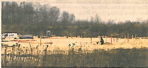
Noch in dieser Woche wird die Betonsohle für das neue Trauerzentrum im Dannenkamp 20 geschüttet.
